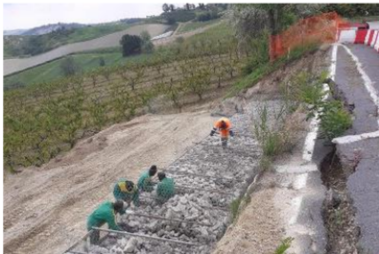
Lavori alla frana del Monticino. In alto via Valletta a fine maggio 2023
